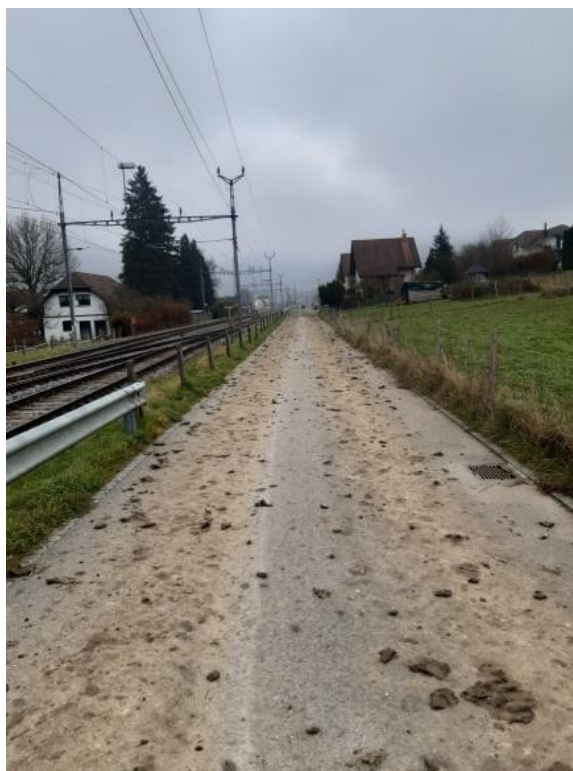
Les rues communales ne doivent pas demeurer dans cet état, qui fait courir des risques aux canalisations
