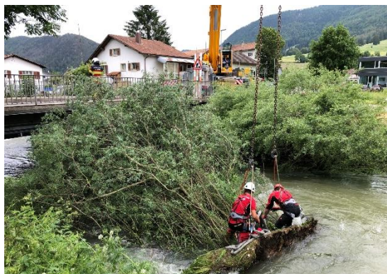
Les dégâts de juin 2021 sont encore dans toutes les mémoires.
