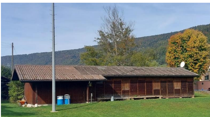
Cet immeuble a bien besoin de soins. Il est actuellement inutilisable
