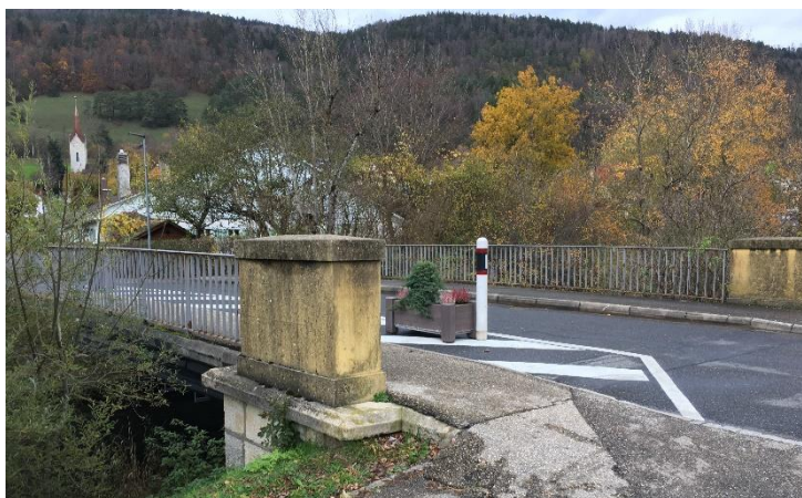
La sécurisation obligatoire des ponts sur la Suze (ici celui de Sombeval) va peser sur les finances communales ces prochaines années
