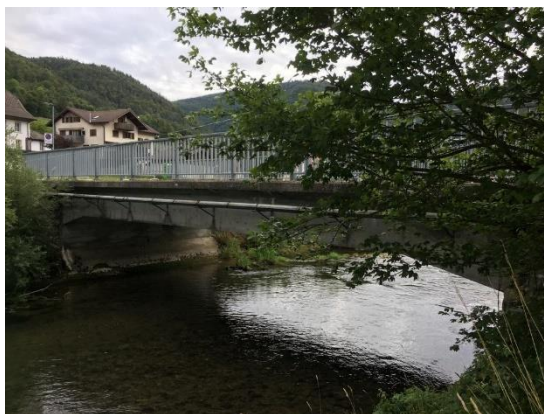
La structure métallique de cet ouvrage est plus endommagée qu'on ne pouvait le penser
