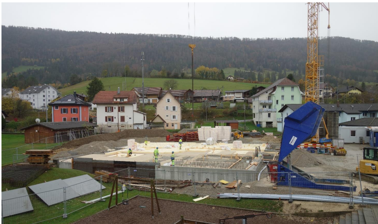
Mardi matin sur le chantier où l'on s'activait notamment à poser l'isolation sous-radier
