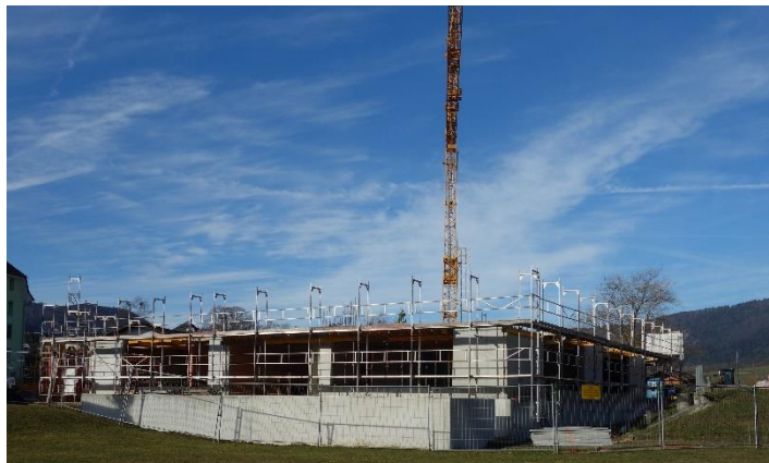
Le rez-de-chaussée a pris forme, la première dalle devrait être coulée lundi
